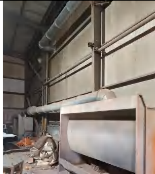
喷漆房废气微负压收集系统及管线
