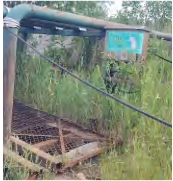
雨水排放口及标识牌
