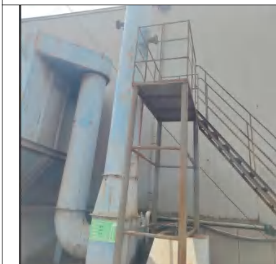
喷砂房废气排放口标识牌及采样平台
