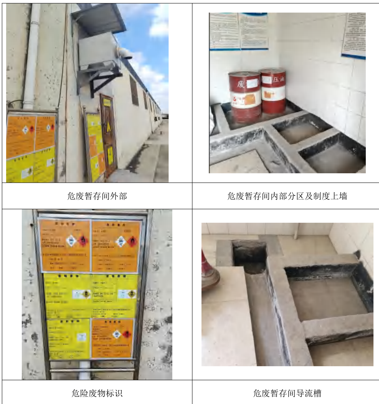
图 4.1-5 危险废物收集措施
