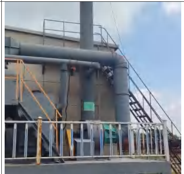
喷漆房废气排放口标识牌及采样平台
