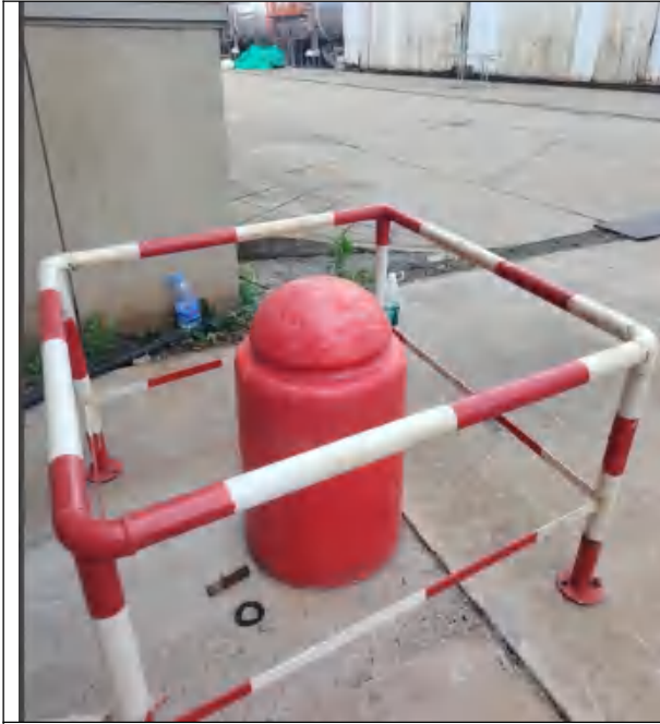
喷漆房外消防栓
