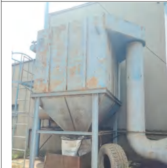
喷漆房废气处理措施（布袋除尘器）
