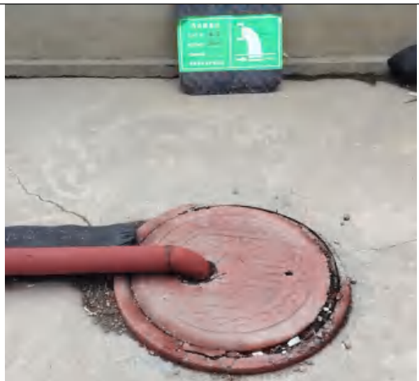
生活污水排放口及标识牌
