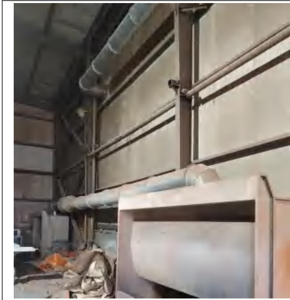
喷漆房废气微负压收集系统及管线
