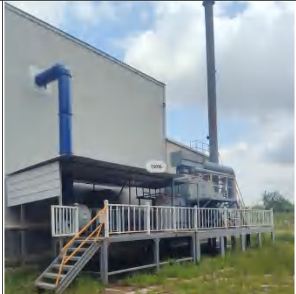
喷漆房废气处理措施（过滤棉吸附+二级袋式滤膜吸附+活性炭吸附+催化燃烧）
