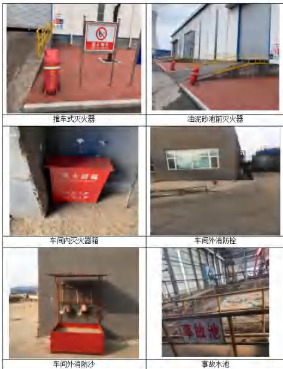
图 6.2-29 现场应急设备设施照片
