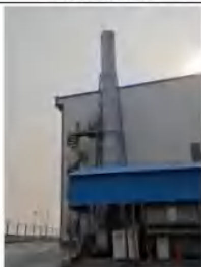
油泥砂贮存间东侧 1#废气处理排气筒 DA002
