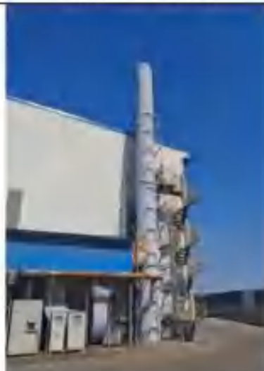
油泥砂贮存间西侧 2#废气处理排气筒 DA004
