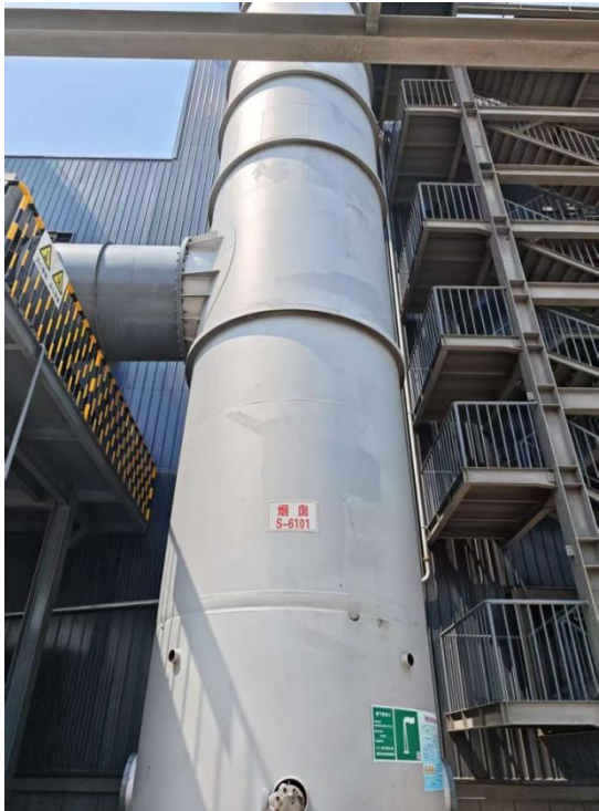
DA004（排气筒P4）采样平台及标识
