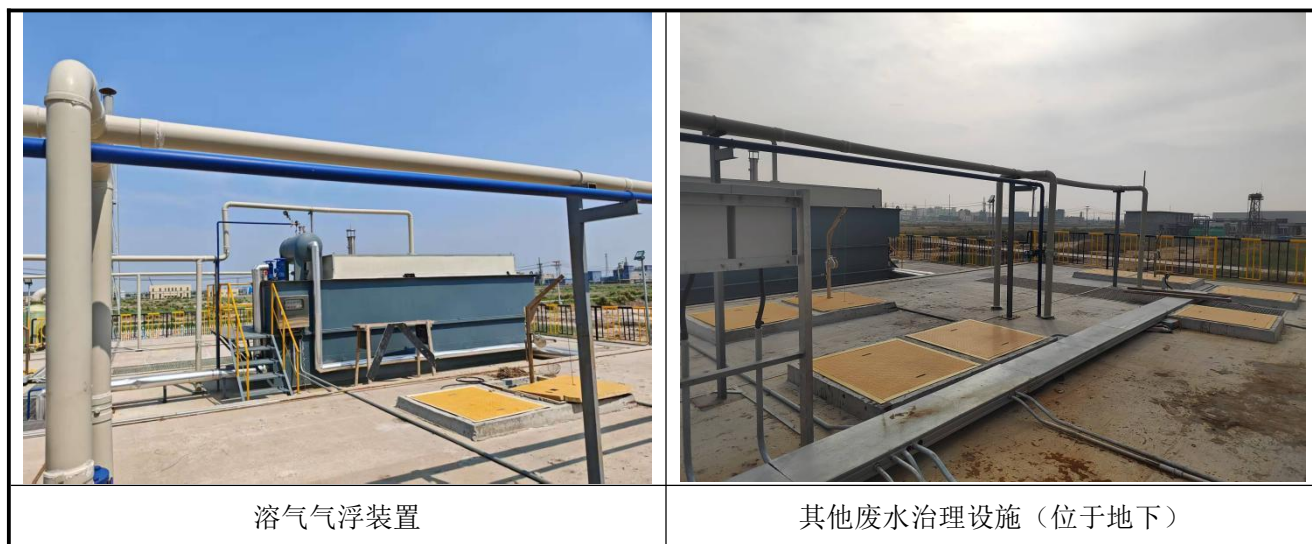
图 4-3 废水治理设施现场照片
