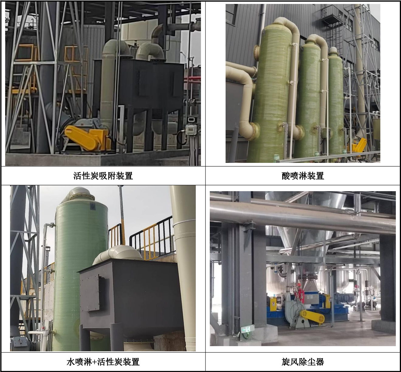
图 4-4 废气治理设施现场照片
