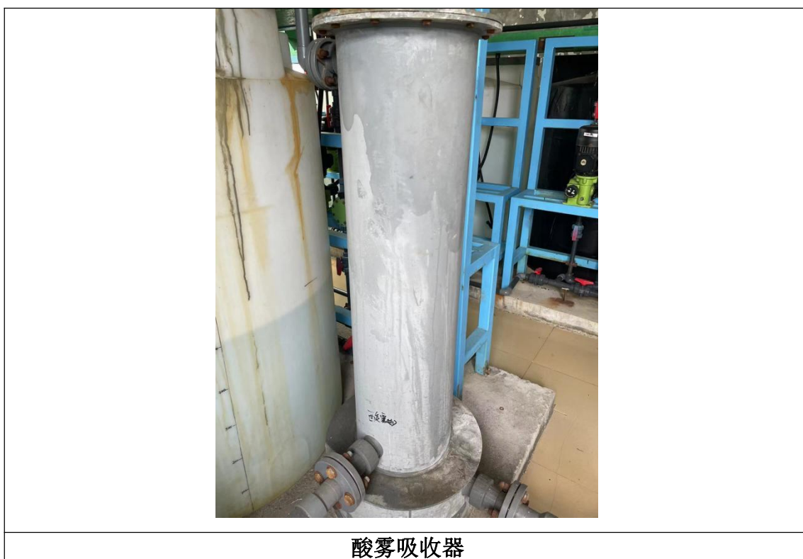
图 4-1 废气治理设施
