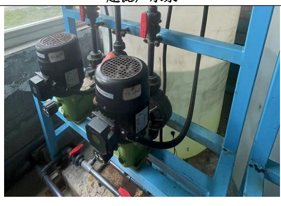
盐酸加药泵/氢氧化钠加药泵
