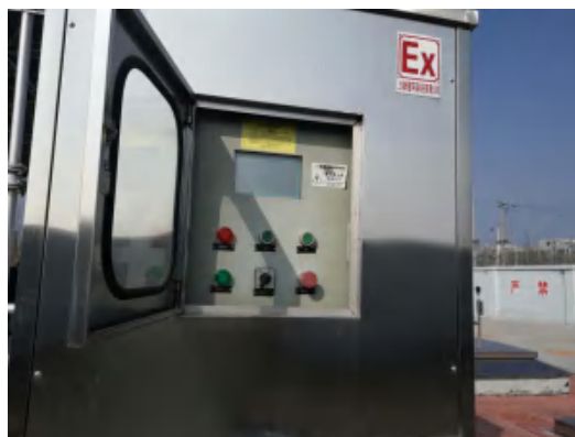
图 7-4 油气回收操作平台
